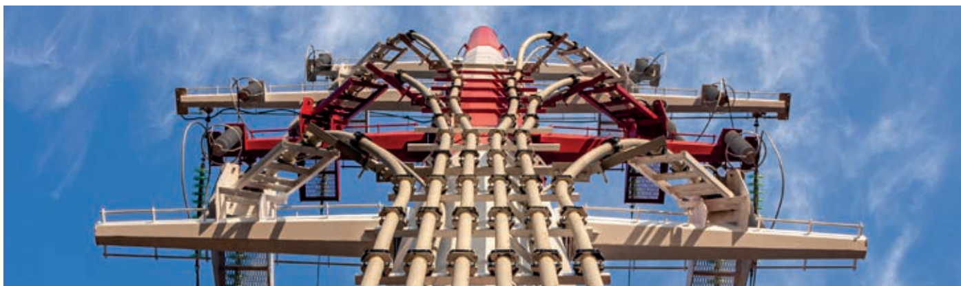
Силовые кабели покрыты огнеупорным покрытием
