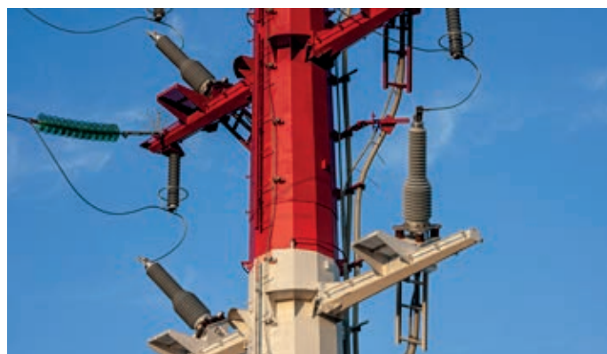
На траверсах выполнены эксплуатационные площадки для обслуживания кабельных муфт.
